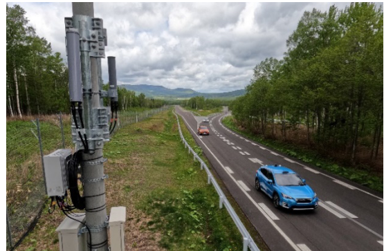
（周回路に設置されたローカル 5G 設備）
