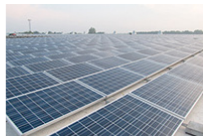
1MWの太陽光発電設備
