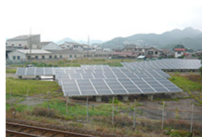
戸建住宅100軒分相当の太陽光発電設備
